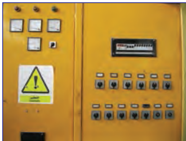
شکل ۵-۱- نمونه‌ای از تابلو برق
